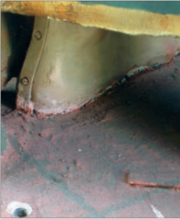
ESTADO INICIAL. SE OBSERVAN REFUERZOS METÁLICOS.
